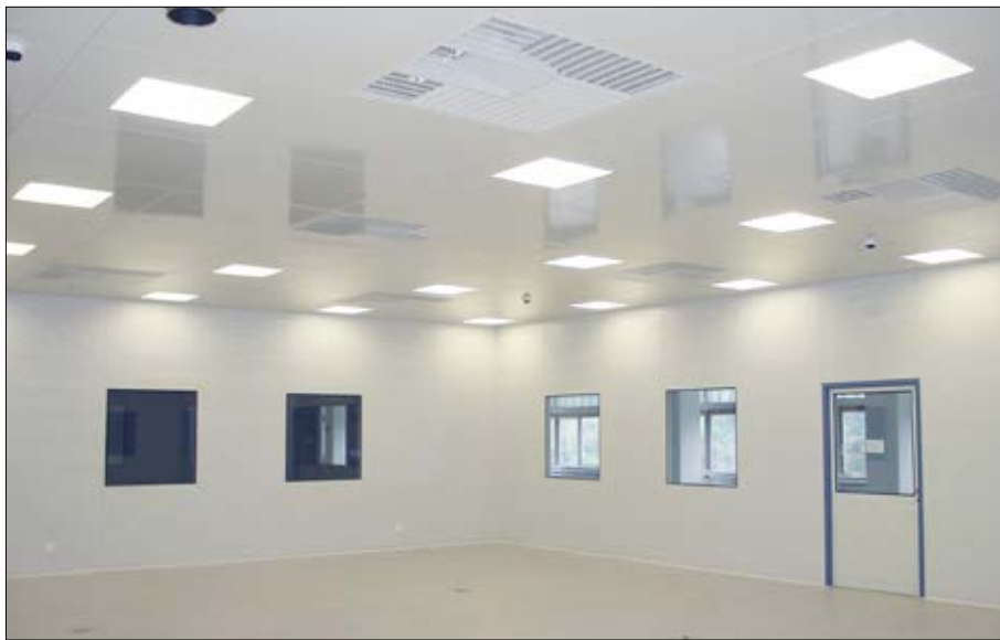
Abbildung 3: Die PIFF Module sind in die Decke des Reinraums integriert.
